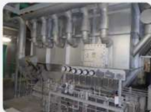
廃棄物処理場向 / 焼却炉
